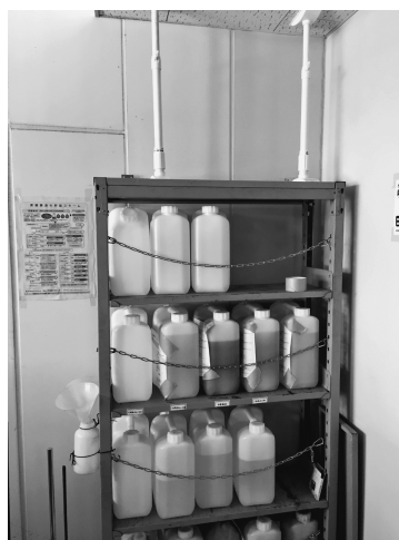
転倒防止用突っ張り棒と落下防止柵を施した棚
